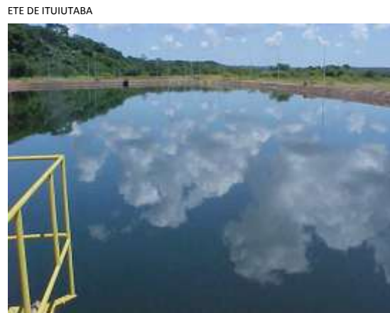
Figura 17: Lagoa de Sedimentação
