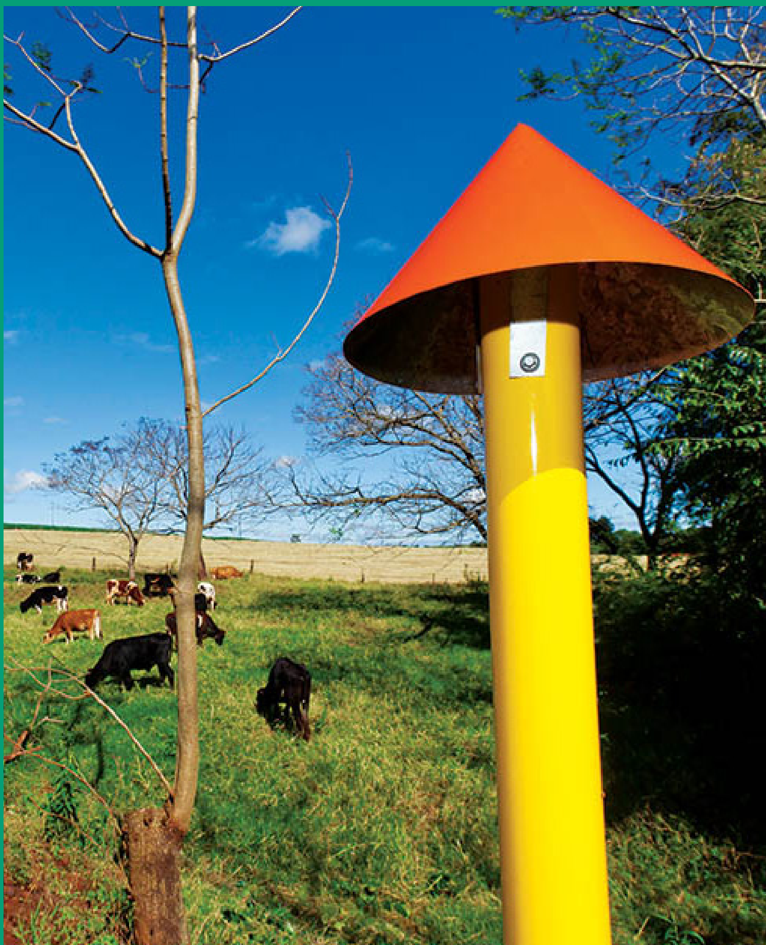
Identificação de gasoduto rural
